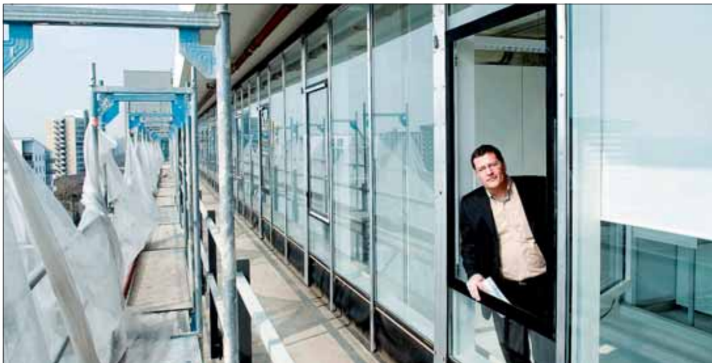
Vollständig eingerüstet ist seit einem Jahr das DKFZ; die 35 Jahre alte Großforschungseinrichtung wird für 76 Millionen Euro komplett saniert. Der siebte Stock ist schon fast fertig, und Carsten Wildemann, Leiter der Abteilung Technik, genießt den Ausblick. Foto: Stefan Kresin
