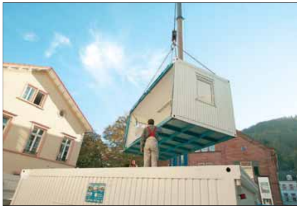
Neun Container wurden gestern rund um das Theater aufgestellt; hier finden die Werkstätten der Städtischen Bühne eine vorläufige Unterkunft. Foto: Joe
